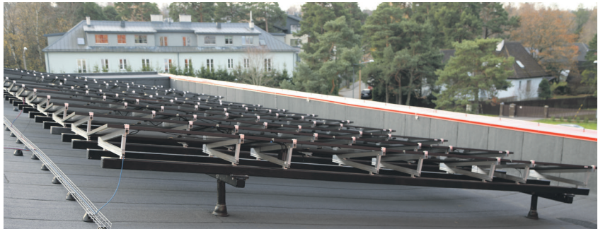
TalTechi Mäemaja päikesepaneelid on paigaldatud aluskonstruktsioonidele toetuvatele pollaritele. See tekitab küll marginaalsed külmasillad, kuid võimaldab korrektset katuse hooldust. Hoonel on kõrged parapetid ja seepärast ei ole vaja ka turvaravastust.
