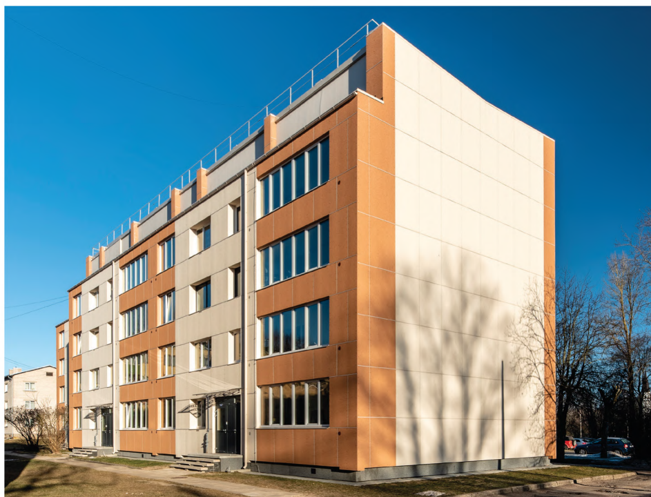
Lätis on paljud kortermajad renoveeritud kvaliteetsete StoneREX Premium kivipuruplaatidega, 2 aastat järjest on võidetud auhinnalisi kohti konkursil "Energiatõhus Renoveerimisobjekt"
