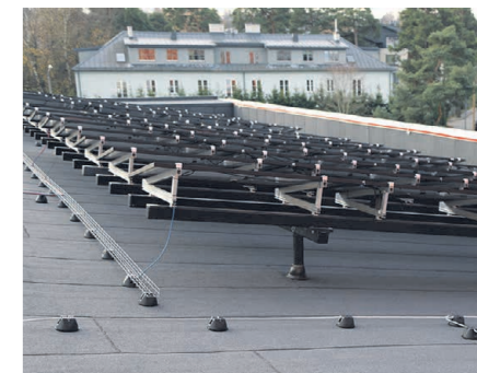
TalTech Mäemaja päikesepaneelid on paigaldatud alusstruktuuridele toetuvatele pollartitele. See tekitab küll marginaalsed külmasillad, kuid võimaldab korrektselt katuse hooldust. Hoonel on kõrgeid parapette ja seepärast ei ole vaja ka turvavarustust Foto: Alo Karu
