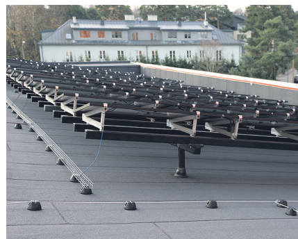
TalTech Mäemaja päikesepaneelid on paigaldatud aluskonstruktsioonidele toetuvatele pollartitele. See tekitab küll marginaalsed külmasillad, kuid võimaldab korrektset katuse hooldust. Hoonel on kõrged parapetid ja seepärast ei ole vaja ka turvavarustust Foto: Alo Karu
