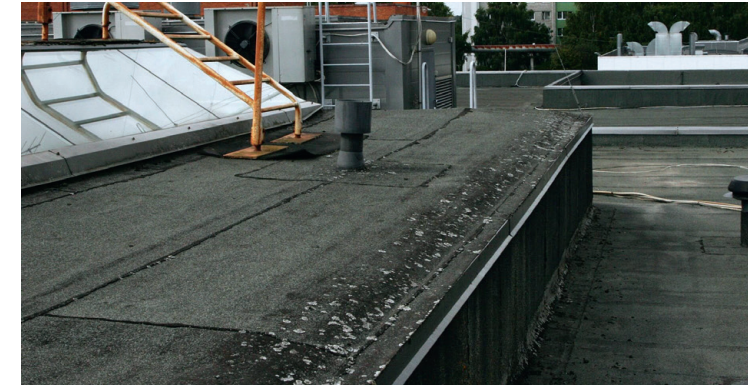
Ilmselt üheksakümnendatel erineval ajal uue bituumenrullmaterjalist hüdroisolatsioonikihi saanud katus on veel veetihed, kuid vananemistunnustega. Omanik planeerib katuse rekonstrueerimist. Foto: Alo Karu
