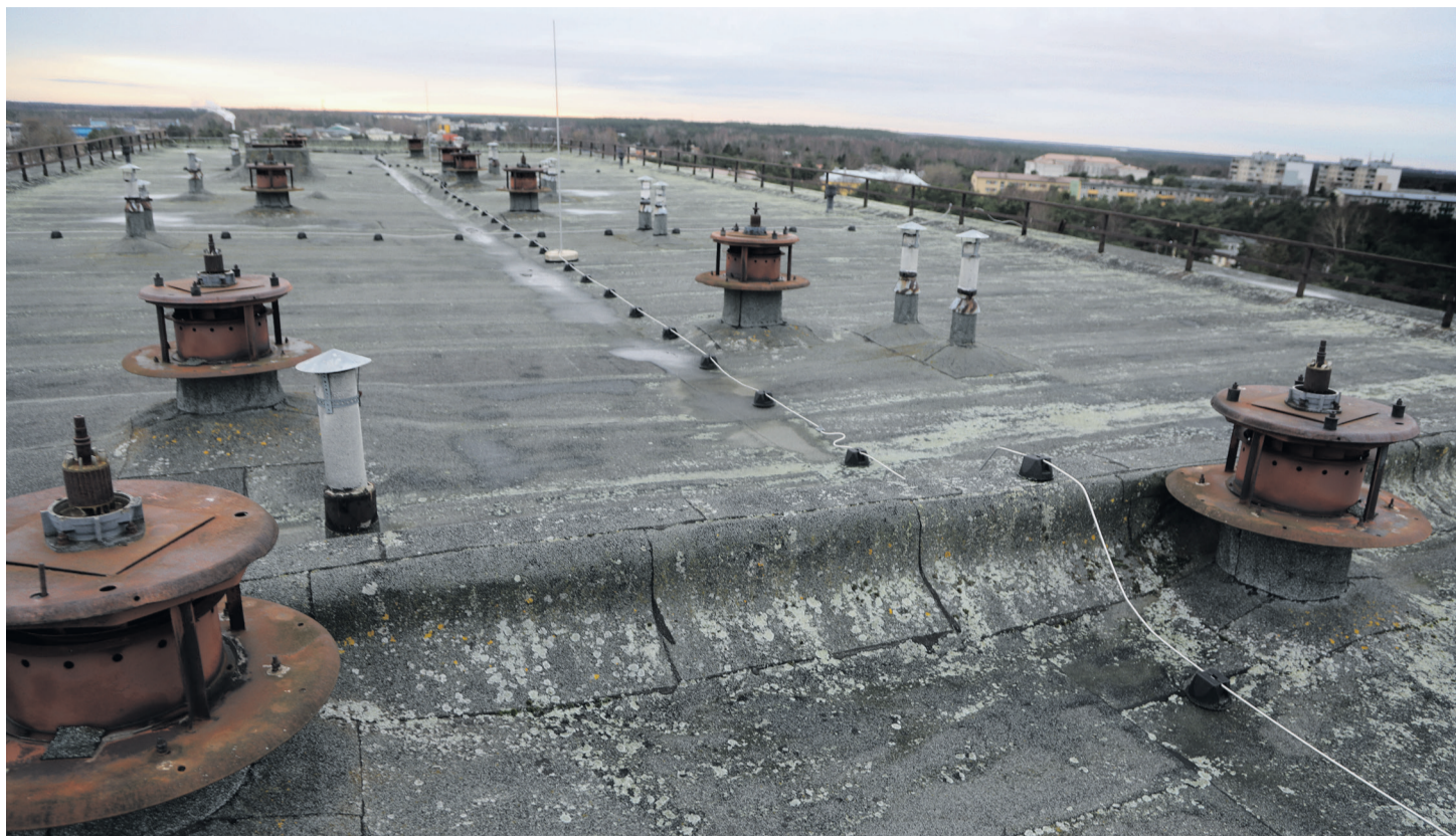
Üheksakümnendatel uue bituumenrullmaterjaliga kaetud katusel on hüdroisolatsiooni ressursid ammendunud. Katustarind ja kogu hoone vajab soojustamist.
