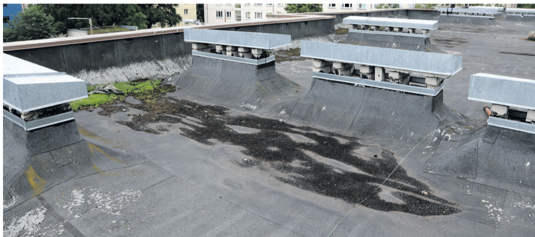
Halvasti õnnestunud katuse remondilahendus ja halb hooldus on viinud katuse enneaegselt kapitaalset remondi vajaduseni.
