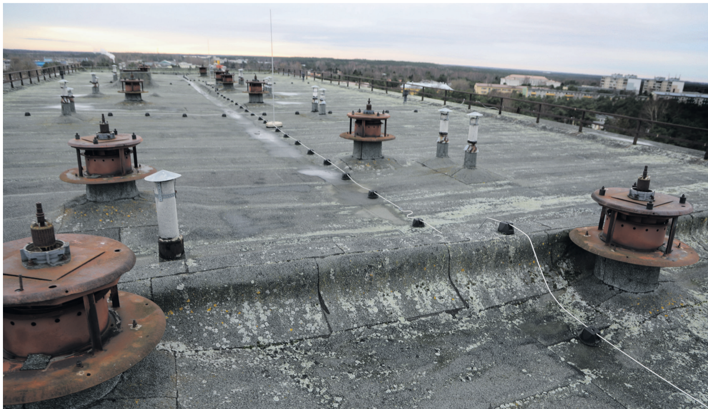
Üheksakümneandel uue bituumenrullmaterjaliga kaetud katusel on hüdroisolatsiooni ressurss ammendunud. Katustarind ja kogu hoone vajab soojustamist.
