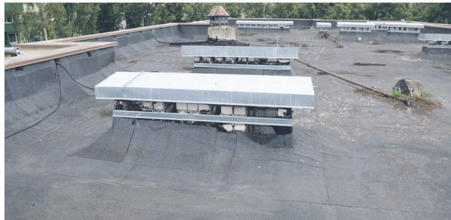
Halvasti renoveeritud ja hooldamata katusel on kihtide vahel vesi. Selline hüdroisolatsioon tuleb eemaldada.
