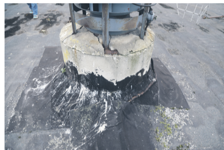
Lohakalt ja ebapädevalt tehtud hüdroisoleerimine ei taga liidete veetihedust. Katusesse ja allaolevatesse ruumidesse sattub vesi.
