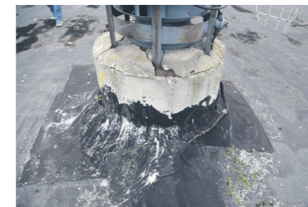
Lohakalt ja ebapädevalt tehtud hüdrosoleerimine ei taga liidete veetihedust. Katusesse ja allaolevatesse ruumidesse sattub vesi.
