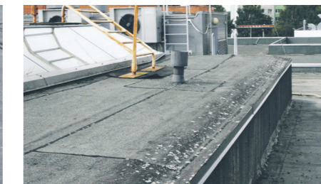
Selline katuse vajab vähemalt uut hüdroisolatsioonikihti juba enam kui 5 aastat tagasi. Sellise katuse puhul ei tea kunagi, kuna ja kustkohast see järgi võib anda.
