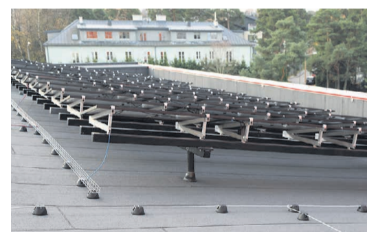
TalTech Mäemaja päikesepaneelid on paigaldatud aluskonstruktsioonidele toetuvatele pollaritele. See tekitab küll marginaalsed külmasillad, kuid võimaldab korrektset katuse hooldust. Hoonel on kõrged parapetid ja seepärast ei ole vaja ka turvavarustust.
