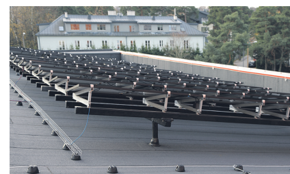
TalTech Mäemaja päikesepaneelid on paigaldatud aluskonstruktsioonidele toetuvatele pollaritele. See tekitab küll marginaalsed külmasillad, kuid võimaldab korrektset katuse hooldust. Hoone on kõrgeid parapetid ja seepärast ei ole vaja ka turvavarustust.
