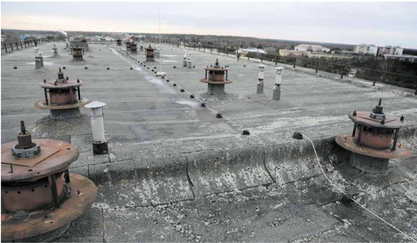
Üheksakümneandel uue bituumenrullmaterjaliga kaetud katusel on hüdroisolatsiooni ressursid ammendunud. Katustarind ja kogu hoone vajab soojustamist.
