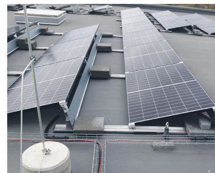
Kaablid ja juhtmed on paigaldatud vett läbilaskvatele alustele. Eeldab korraldada katuse spetsialsetele alustele. (Eesti). Kaablirennid võiks olla pealt kaetud.
