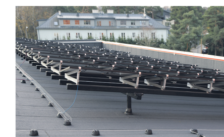
TalTech Mäemaja päikesepaneelid on paigaldatud aluskonstruktsioonidele toetuvatele pollaritele. See tekitab küll marginaalsed külmalsillid, kuid võimaldab korrektselt katuse hooldust. Hoone on kõrgeid parapette ja seepärast ei ole vaja ka turvaravustust.
