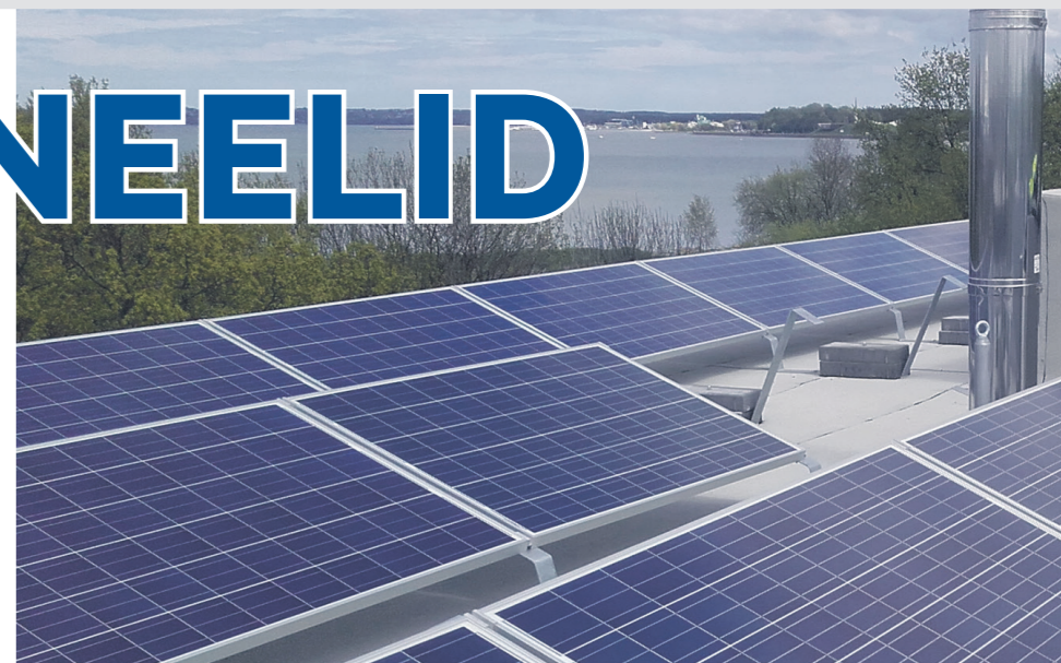
Lattraust paneelide alus on kohati otse katusekattel. Kinnitused läbivad katusekatet. Selline paigaldusviis on katusekattele kahjulik.
