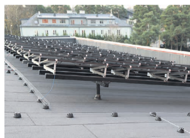
TalTech Mäemaja päikesepaneelid on paigaldatud aluskonstruktsioonidele toetuvatele pollartitele. See tekitab küll marginaalsed külmasillad, kuid võimaldab korrektset katuse hooldust. Hoonel on kõrgeid parapetid ja seepärast ei ole vaja ka turvaravustust.
