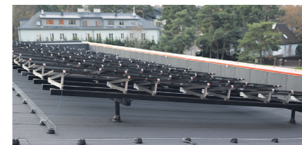
TalTech Mäemaja päikesepaneelid on paigal- datud aluskonstruktsioonidele toetuvatele pollartitele. See tekitab küll marginaalsed külmasillad, kuid võimaldab korrektselt katuse hooldust. Hoonel on kõrged parapetid ja seepärast ei ole vaja ka turvavarustust Foto: Alo Karu
