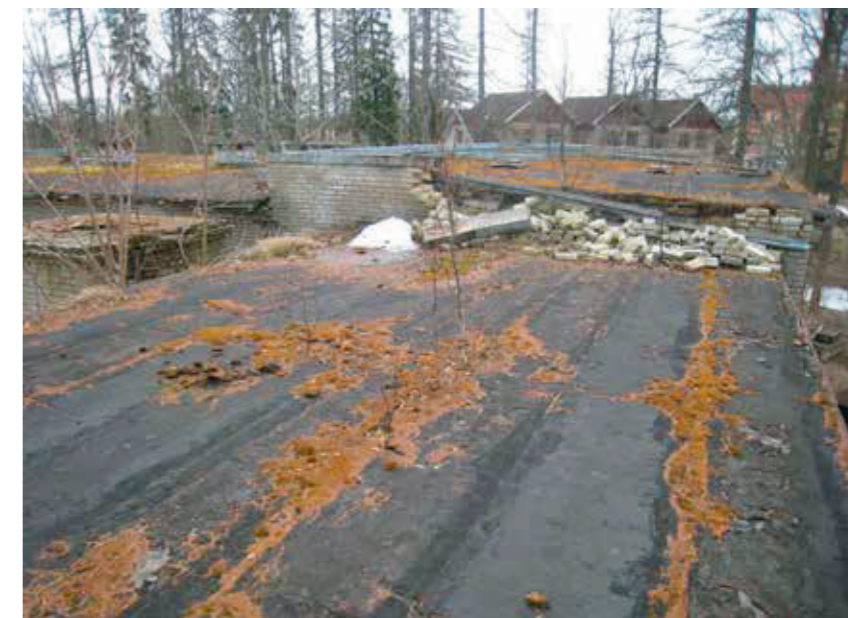
Kui jätta probleemne koht liiga pikaks ajaks karmide ilmaolude räsida, on selle parandamine ja tagajärgede likvideerimine tunduvalt kallim ning ajamahukam kui õigeaegne remont. FOTO: OÜ EVARI EHITUS
