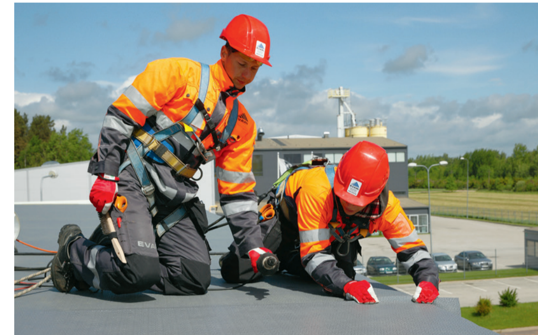
Katuse remont tasub usaldada kogemustega spetsialistidele usaldusväärsest ettevõttest. FOTO: OÜ EVARI EHITUS
