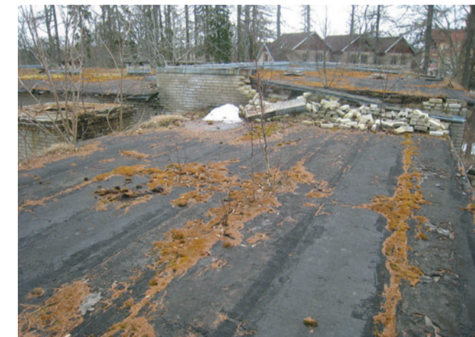
Kui jätta probleemne koht liiga pikaks ajaks karmide ilmaolude räsida, on selle parandamine ja tagajärgede likvideerimine tunduvalt kallim ning ajamahukam kui õigeaegne remont. FOTO: OÜ EVARI EHITUS
