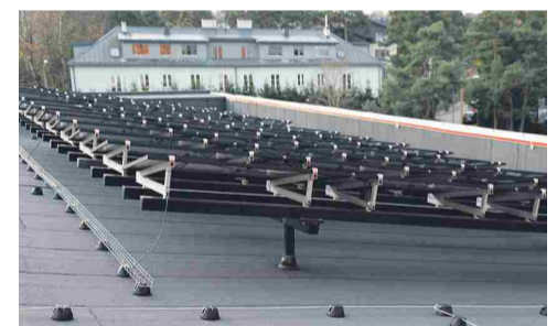
TalTech Mäemaja päikesepaneelid on paigaldatud aluskonstruktsioonidele toetuvatele pollartiteile. See tekitab küll marginaalsed külmasillad, kuid võimaldab korrektset katuse hooldust. Hoonel on kõrge parapetid ja seepärast ei ole vaja ka turvavarustust.
