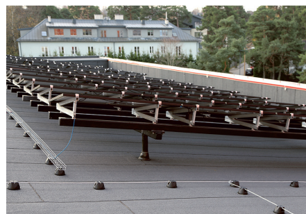
TalTech Mäemaja päikesepaneelid on paigaldatud aluskonstruktsioonidele toetuvatele pollaritele. See tekitab küll marginaalsed külmasillad, kuid võimaldab korrektset katuse hooldust. Hoonele on kõrgeid parapetid ja seepärast ei ole vaja ka turvavarustust
