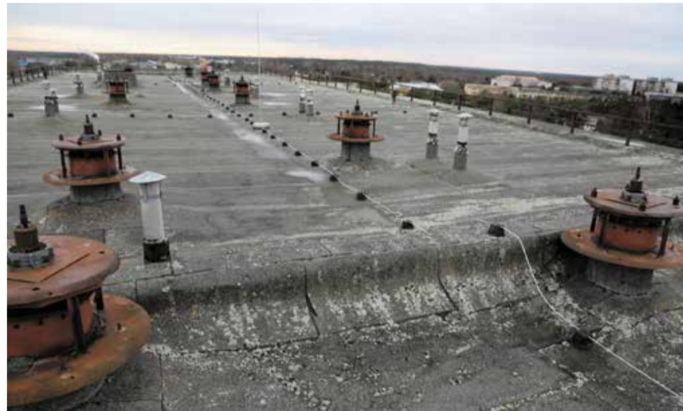
Üheksakümneendatel uue bituumenrullmaterjaliga kaetud katusel on hüdroisolatsiooni ressurss ammendunud. Katuse tarind ja kogu hoone vajab soojustamist. Foto Alo Karu
