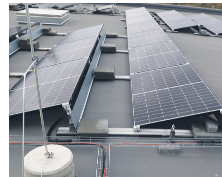
Kaablid ja juhtmed on paigaldatud vett läbilaskvatele rennidetele, kus hoone ümber on palju kõrgeid puid, kust eralduvad lehed ja okkad moodustavad paneelide alla valde, mille eemaldamine on ebamugav, aeganõudev ja raske.
