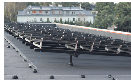
TalTech Mäemaja päikesepaneelid on paigaldatud aluskonstruktsioonidele toetuvatele pollaritele. See tekitab küll marginaalsed külmasilad, kuid võimaldab korrektselt katuse hooldust. Hoonel on kõrge parapetid ja seepärast ei ole vaja ka turvaravustust.
