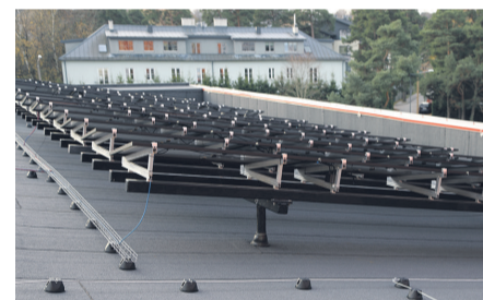
TalTech Mäemaja päikesepaneelid on paigaldatud alusstruktuuridele toetuvatele pollaritele. See tekitab küll marginaalsed külmasillad, kuid võimaldab korrektset katuse hooldust. Hoonel on kõrgeid parapette ja seepärast ei ole vaja ka turvavarustust.
