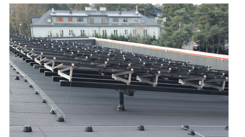
TalTech Mäemaja päikesepaneelid on paigaldatud alusstruktuuridele toetuvatele pollaritele. See tekitab küll marginaalsed külmasilad, kuid võimaldab korrektset katuse hooldust. Hoonel on kõrgeid parapetid ja seepärast ei ole vaja ka turvavarustust.
