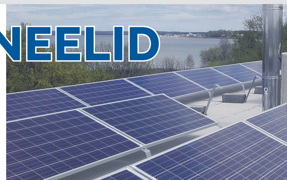
Lattrauast paneelide alus on kohati otse katusekattel. Kinnitused läbivad katusekatet. Selline paigaldusviis on katusekattete kahjulik.
