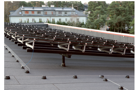
TalTech Mäemaja päikesepaneelid on paigaldatud aluskonstruktsioonidele toetuvatele pollaritele. See tekitab küll marginaalsed külmasillad, kuid võimaldab korrektset katuse hooldust. Hoonele on kõrgeid parapetid ja seepärast ei ole vaja ka turvavarustust
