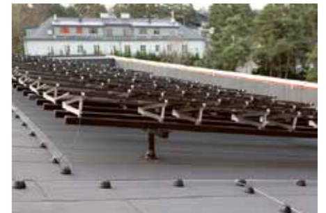
TalTech Mäemaja päikesepaneelid on paigaldatud aluskonstruktsioonidele toetuvatele pollaritele. See tekitab küll marginaalsed külmasillad, kuid võimaldab korrektset katuse hooldust. Hoonel on kõrged parapetid ja seepärast ei ole vaja ka turvavarustust
