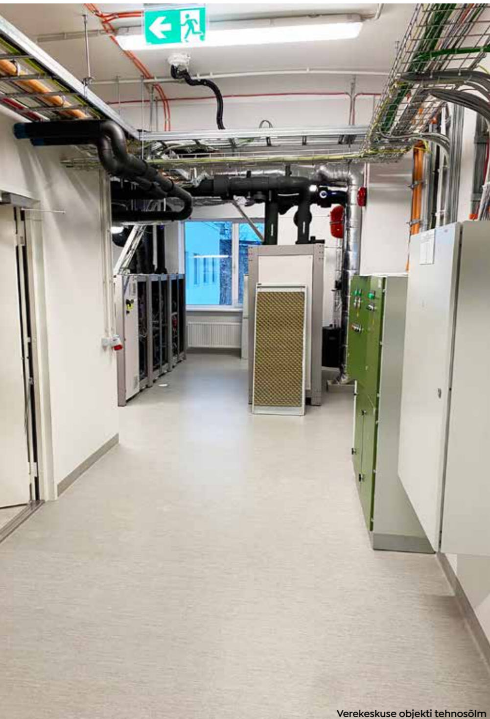
Verekeskuse objekti tehnosõlm
