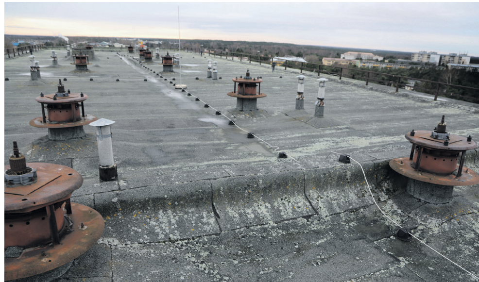
Üheksakümnendatel uue bituumenrullmaterjaliga kaetud katusel on hüdroisolatsiooni ressurss ammendunud. Katuse tarind ja kogu hoone vajab soojustamist. Foto Alo Karu
