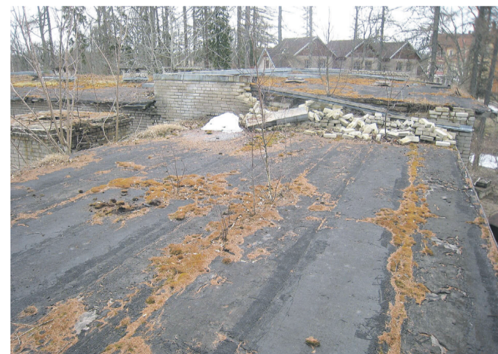
Kui jätta probleemne koht pikaks ajaks karmide ilmaolude räsida, on selle parandamine ja tagajärgede likvideerimine tunduvalt kallim ja ajamahukam kui õigeaegne remont.
