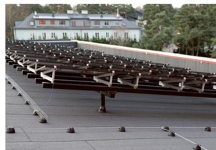
TalTech Mäemaja päikesepaneelid on paigaldatud aluskonstruktsioonidele toetuvatele pollaritele. See tekitab küll marginaalsed külmasillad, kuid võimaldab korrektset katuse hooldust. Hoonele on kõrgeid parapetid ja seepärast ei ole vaja ka turvavarustust
