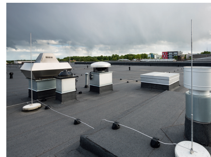
Katuse läbiviigid. Foto: OÜ Evari Ehitus
