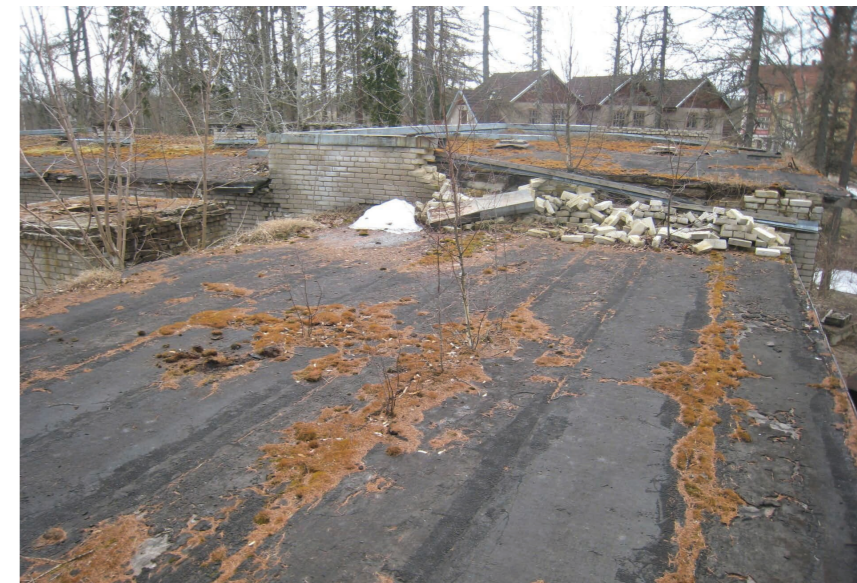
Kui jätta probleemne koht liiga pikaks ajaks karmide ilmaolude räsida, on selle parandamine ja tagajärgede likvideerimine tunduvalt kallim ning ajamahukam kui õigeaegne remont. FOTO: OÜ EVARI EHTUS
