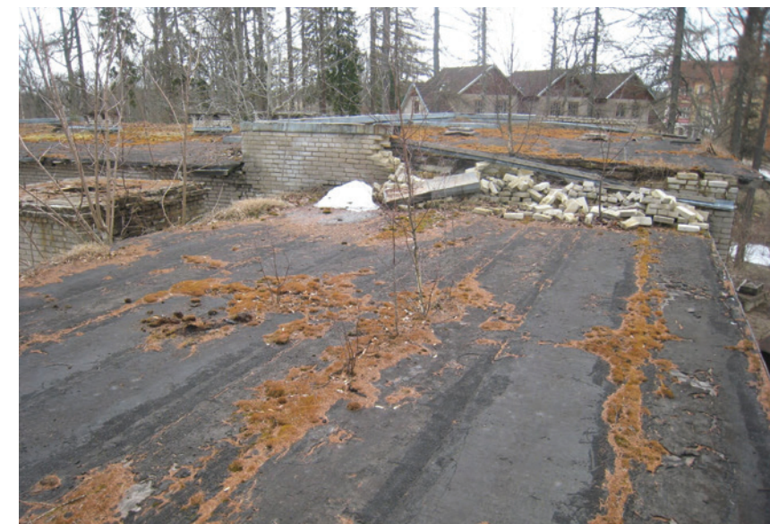
Kui jätta probleemne koht liiga pikaks ajaks karmide ilmaolude räsida, on selle parandamine ja tagajärgede likvideerimine tunduvalt kallim ning ajamahukam kui õigeaegne remont. FOTO: OÜ EVARI EHITUS
