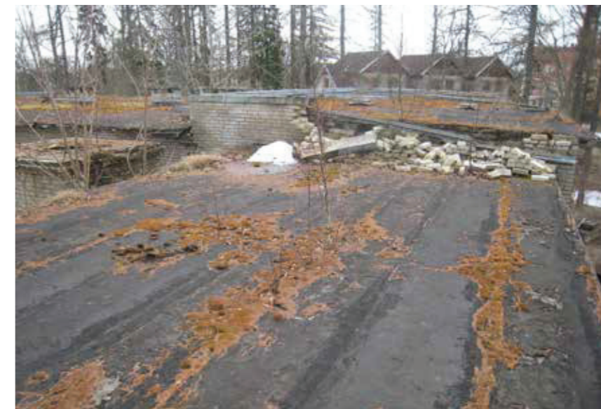
Kui jätta probleemne koht liiga pikaks ajaks karmide ilmaolude räsida, on selle parandamine ja tagajärgede likvideerimine tunduvalt kallim ning ajamahukam kui õigeaegne remont. FOTO: OÜ EVARI EHITUS
