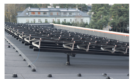
TalTech Mäemaja päikesepaneelid on paigaldatud aluskonstruktsioonidele toetuvatele pollaritele. See tekitab küll marginaalsed külmasillad, kuid võimaldab korrektselt katuse hooldust. Hoone on kõrgeid parapetid ja seepärast ei ole vaja ka turvavarustust.
