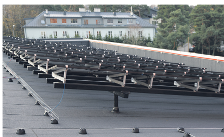
TalTech Mäemaja päikesepaneelid on paigaldatud aluskonstruktsioonidele toetuvatele pollaritele. See tekitab veel marginaalsed külmasillad, kuid võimaldab korrektselt katuse hooldust. Hoonel on kõrge parapetid ja seepärast ei ole vaja ka turvavarustust.
