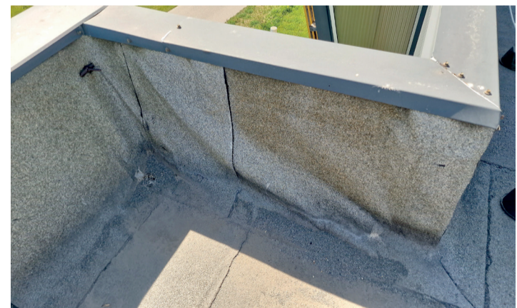
Kortsus ja halvas seisus parapeti ülespöore, mis tekitab lume sulamisel uputuse. Vajalik teostada põhjalik renoveerimine.
