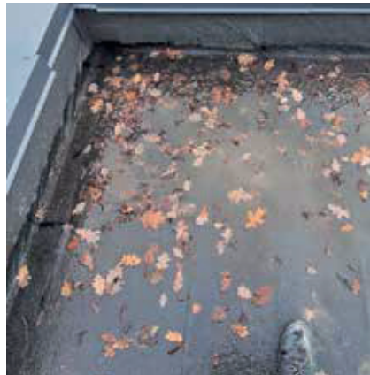
Lehed on vaja sügisel eemaldada, et vältida vee äravoolu takistamist. Sel pildil on näha, et pleki- ja rullmaterjalitööd on tehtud ebakorrektselt ning risk leketeks on suur.
