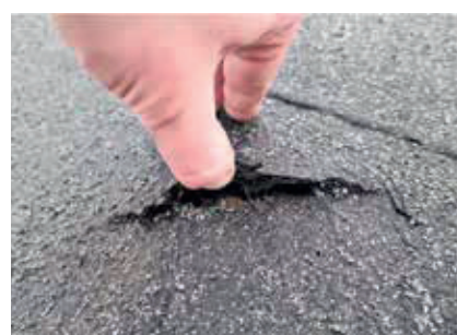
Katusel toimunud tegevuse käigus on katusekatet kahjustatud. Sellised kohad tuleb kiiremas korras paigata, et vältida suuremaid kahjustusi.
