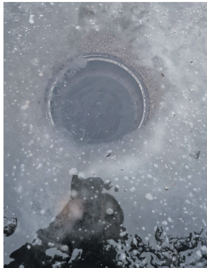
Ummistunud katusekaev talvel. Lääbijäätmisel võib katusekaev puruneda. Tuleb veenduda, et kaevu küttegaabel on talvel sisse lülitatud.
