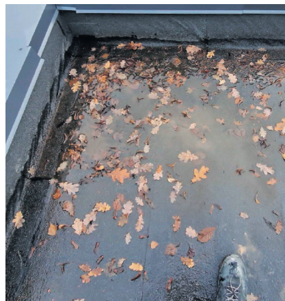
Осенью листья необходимо убирать, чтобы не забивать водоотвод. На этом фото видно, что работы с металлочерепицей и рулонными материалами выполнены некачественно, риск протечек высок.
