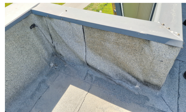
Kortsus ja halvas seisus parapeti ülevaade, mis tekitab lume sulamisel uputuse. Vajalik teostada põhjalik renoveerimine.
