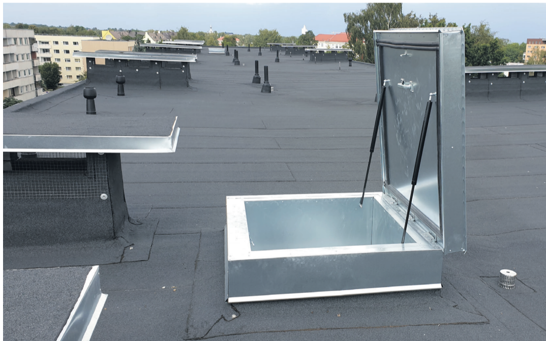
Amortiseerunud ja oma aja ära elanud katusega võivad kaasneda mitmesugused ebameeldivad üllatused just siis, kui ilmaolud on ekstreemsed ja kiire parandamine väga raske.
