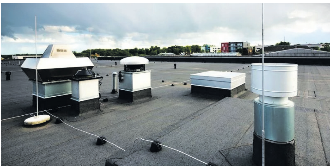
Läbiviik on koht, kus katuse kaudu viiakse läbi kaabel, toru, ventilatsioon, antenn, kliimaseade või muu seade, mis vajab ühendust hoone sisemuse ja välise keskkonna vahel.
