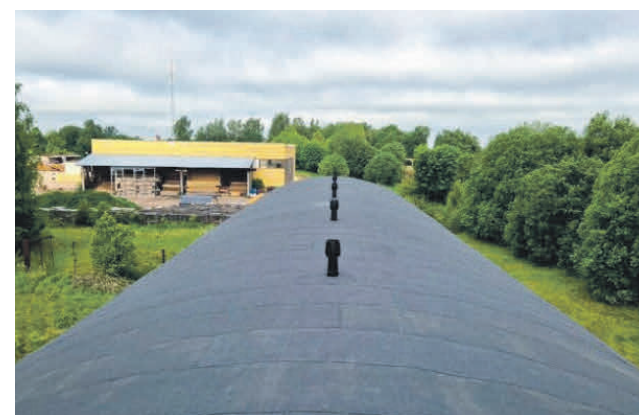
Terviklik kaarhalli renoveerimine hõlmab ka toimiva tuulutusüsteemi ehitust, mis juhib katusekonstruktsioonist jääniiskuse välja.
